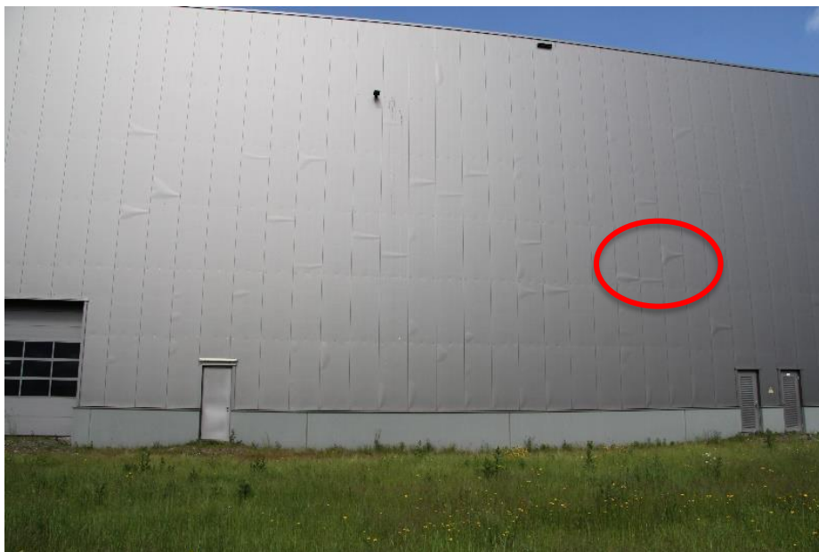
Abbildung 1: Blasenbildung an der Außenseite einer Sandwichfassade
